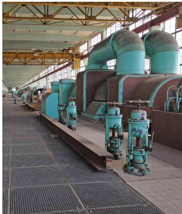
Innenansicht Kraftwerk Frimmersdorf © Zweckverband LANDFOLGE
