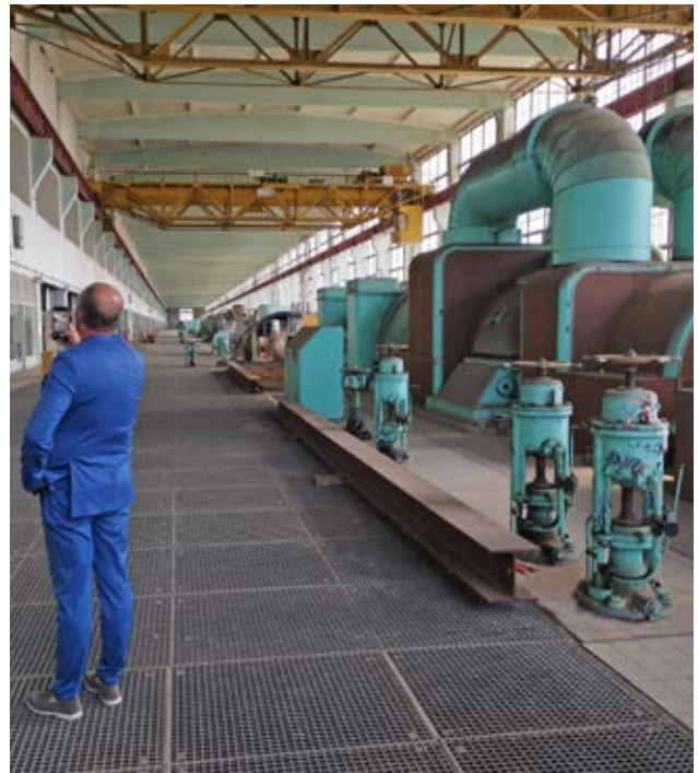
Innenansicht Kraftwerk Frimmersdorf © Zweckverband LANDFOLGE
