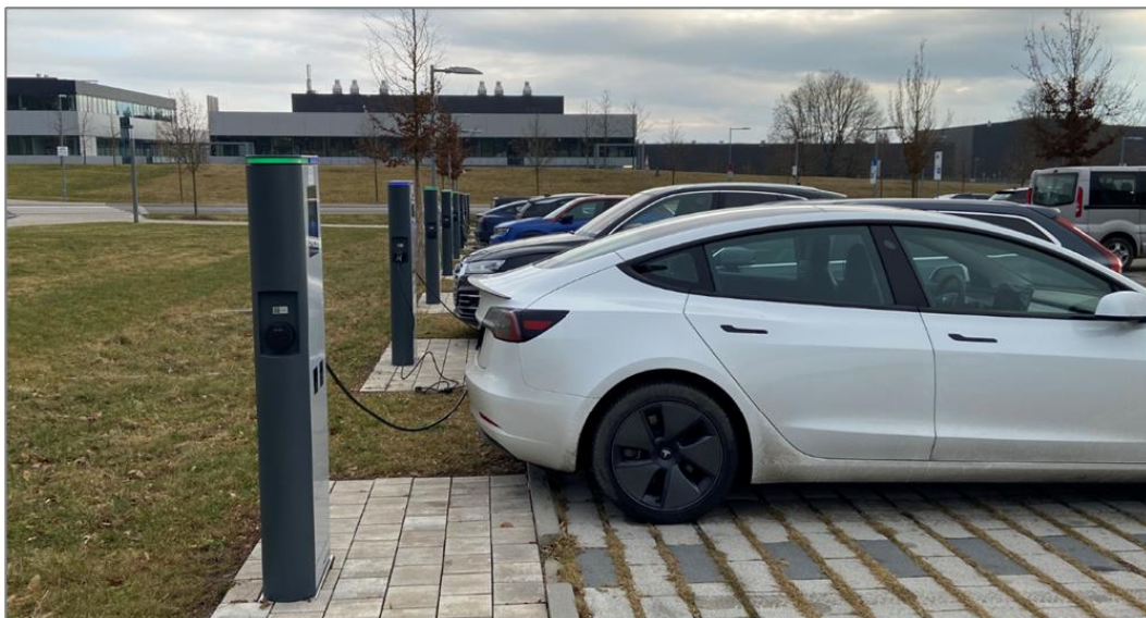
Abbildung 5 AC-Ladestationen bei Firmen, Foto Wagner
