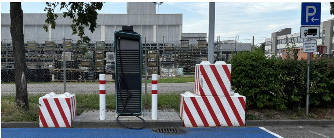
Abbildung 6 LKW Depotladung, mit Anfahrtschutz aus BetonFoto Wagner
