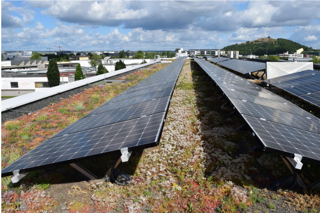
Abbildung 20 Exemplarische Dach-PV-Anlage mit Dachbegrünung (Bundesverband GebäudeGrün, 2023)
